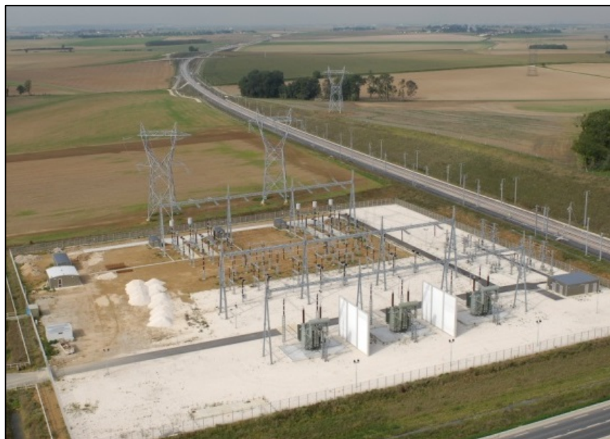
Figure 32 : Sous-station électrique (source : SNCF Réseau)
