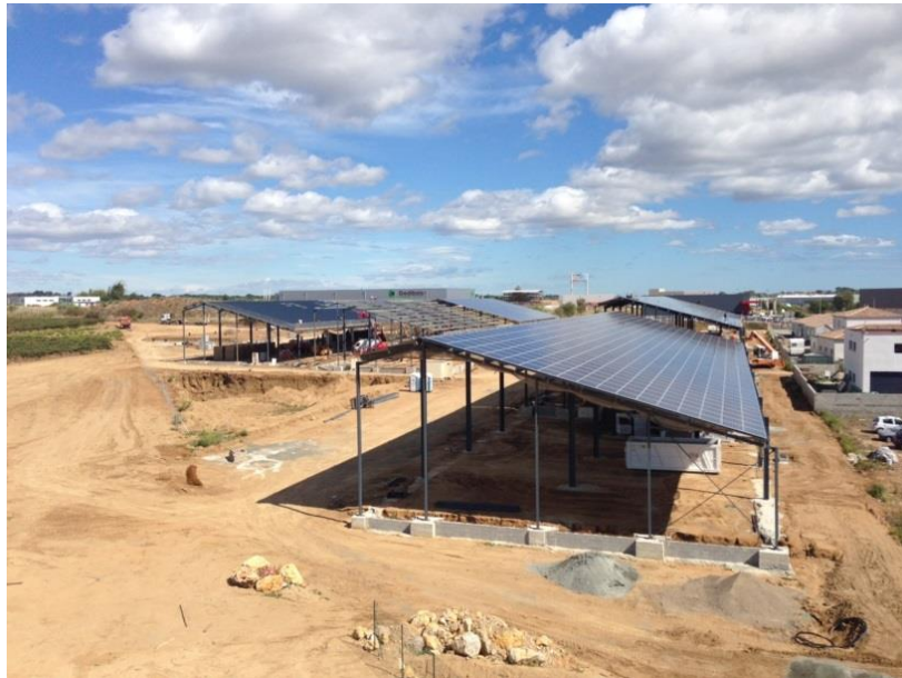
Figure 25 : Photo de la centrale solaire de Villeneuve-lès-Béziers (source : SOLVEO ENERGIE)
