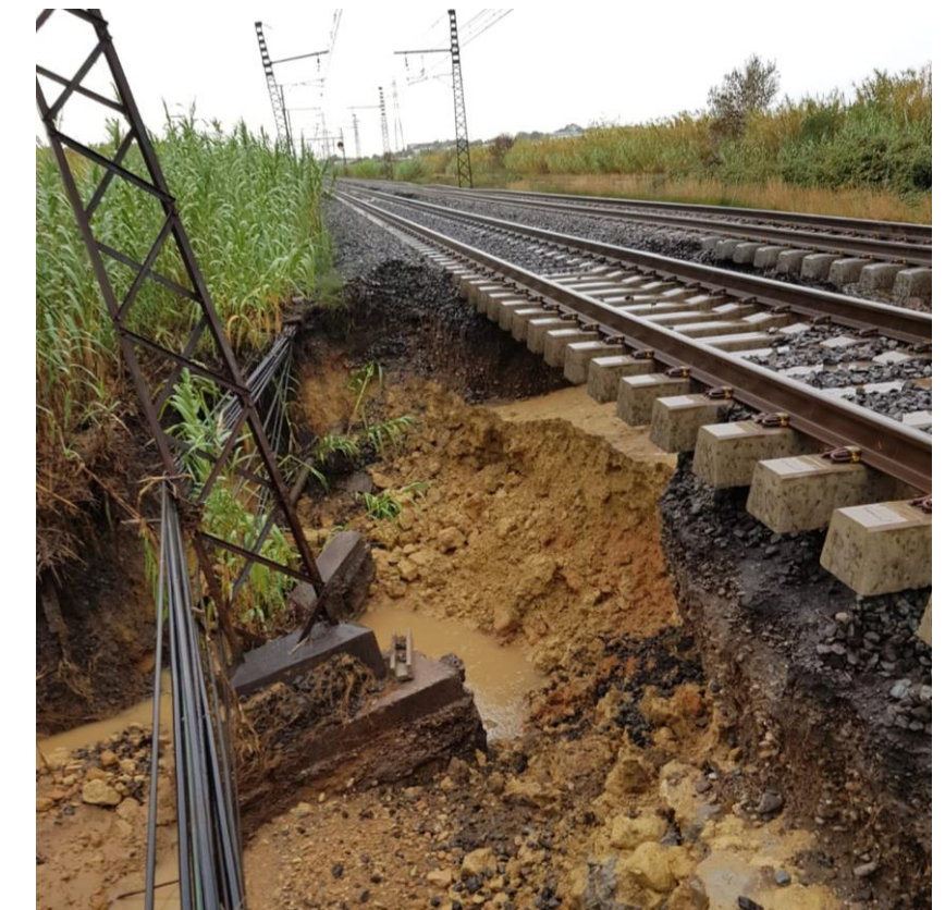
Figure 80 : Dégâts causés par les inondations d'octobre 2019 (source : SNCF Réseau)
