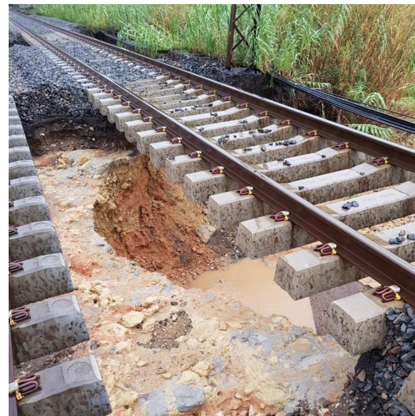
Figure 78 : Dégâts causés par les inondations d'octobre 2019 (source : SNCF Réseau)
