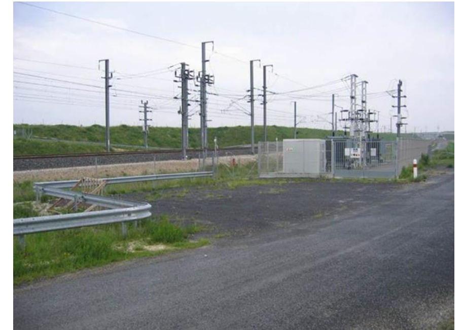
Figure 128 - Poste d'auto-transformation et son accès routier (source : SNCF Réseau)
