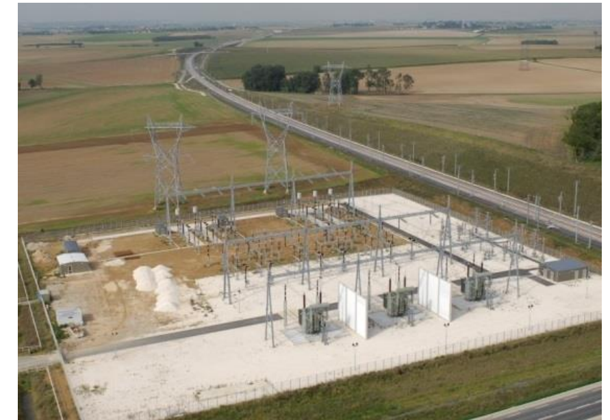
Figure 98 - Sous-station électrique (source : SNCF Réseau)
