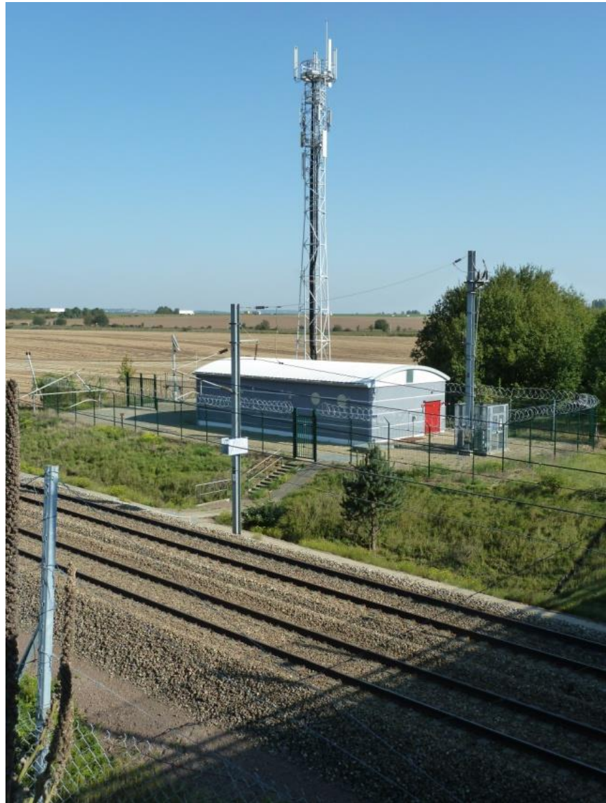
Figure 124 - Centre de signalisation et antenne GSM-R (source : INGEROP)
