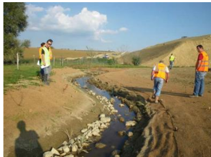
Figure 15 : Recréation d'un cours d'eau rescindé sur la LGV Est Européenne (source : ONEMA)
