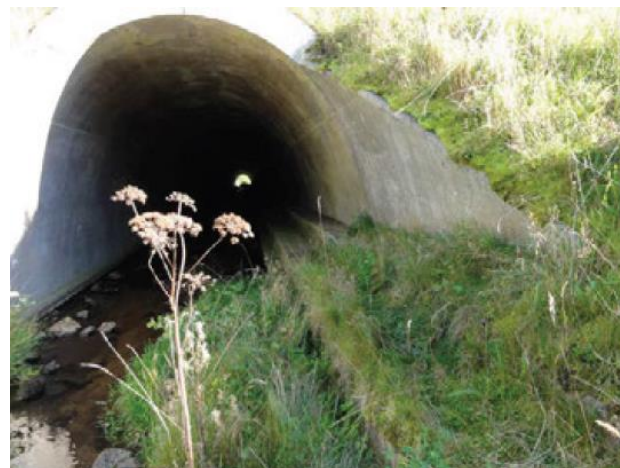
Figure 20 : Ouvrage aménagé sur un côté pour le passage de la faune semi-aquatique
